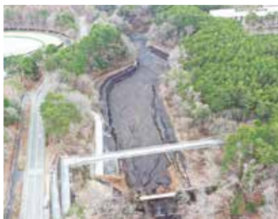
土砂を食い止めた宮川堰堤
