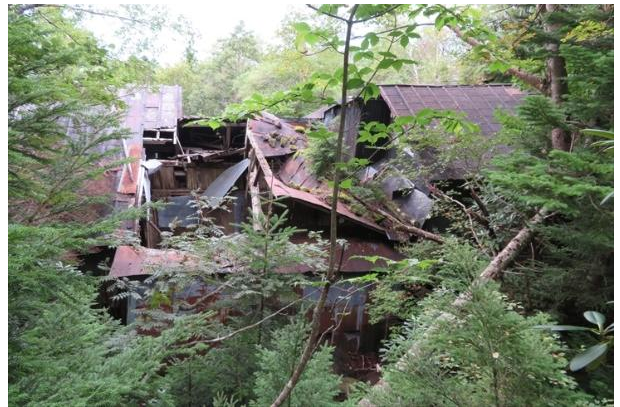
図 4-6 四合五勺御座石浅間神社の損傷状況
