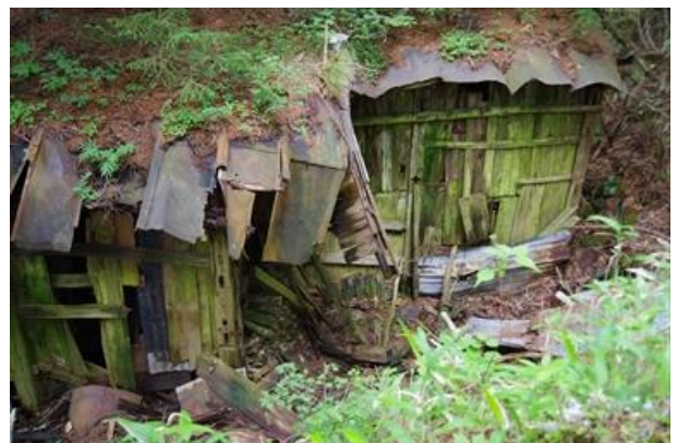
図 4-2 一合目鈴原社の損傷状況
