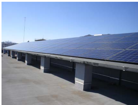
下吉田東小学校屋上に 設置された太陽光パネル
