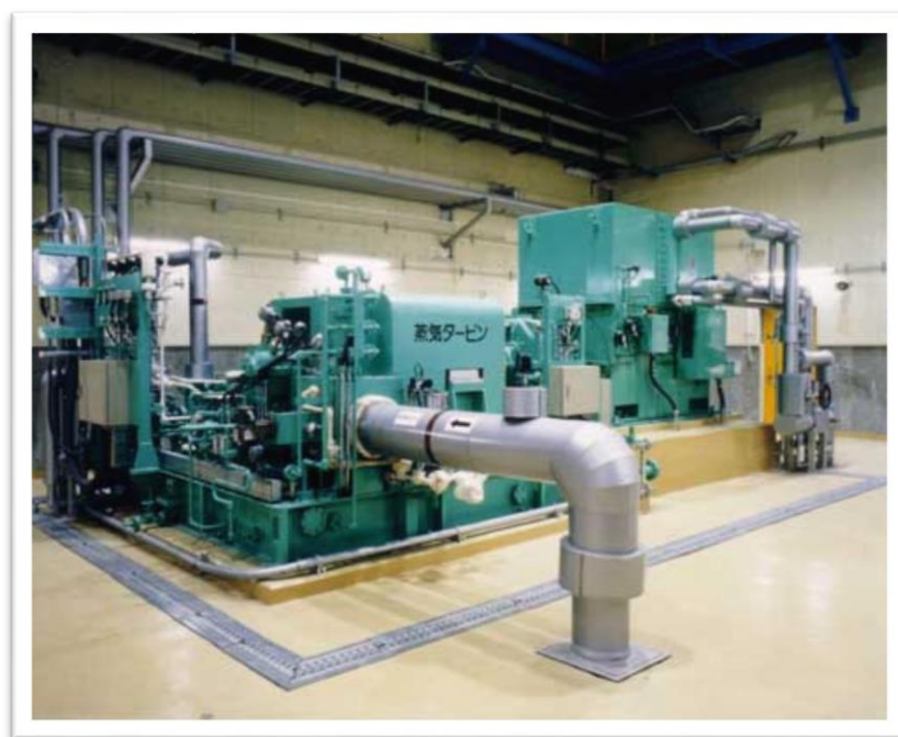
環境美化センター蒸気発電タービン
