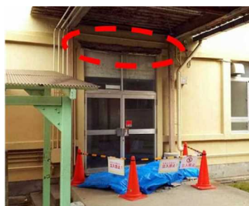
赤線部分にあった庇が落下
